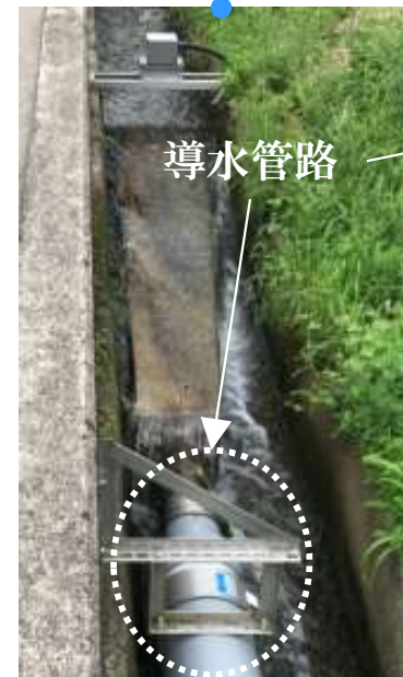
排水路取水点
