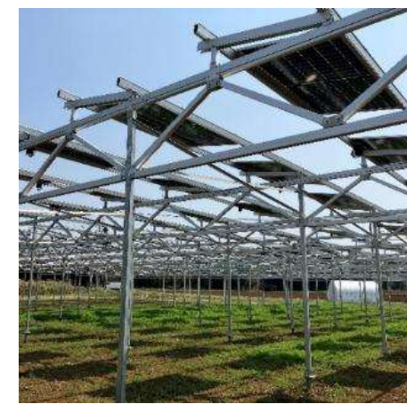
太陽光パネル・架台
