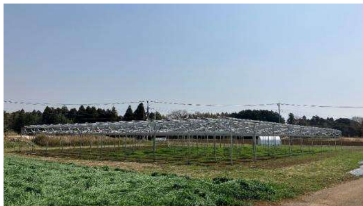
大木戸ソーラー発電所 全体像
