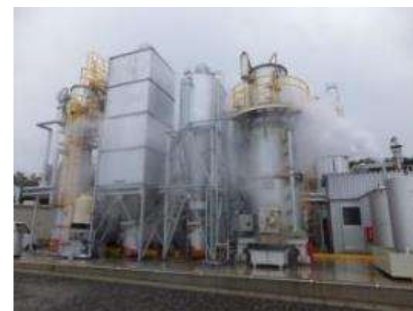
バイオマス設備
