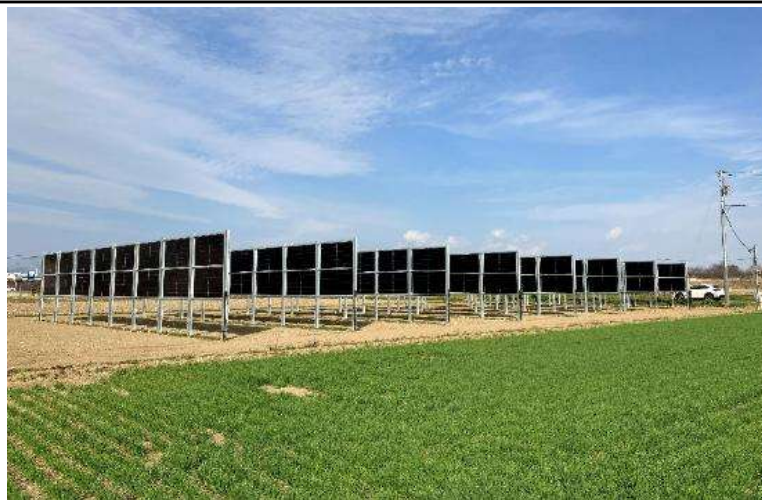
太陽光発電設備の全体像
