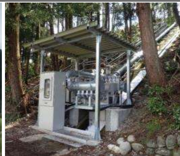
小水力発電設備の外観
