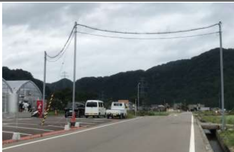
発電所からハウスへの送電線 ©2025 JMA Consultants Inc.
