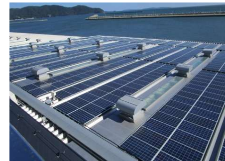
屋根に張り巡らされた太陽光パネル
