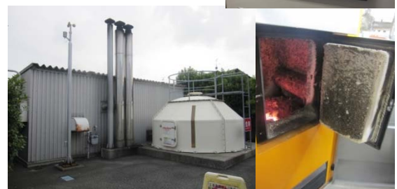
ボイラー室(左)とペレットサイロ(右)
