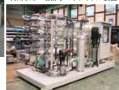
逆浸透膜(ROメンブレンフィルタ)を利用した工場排水のリサイクル装置
