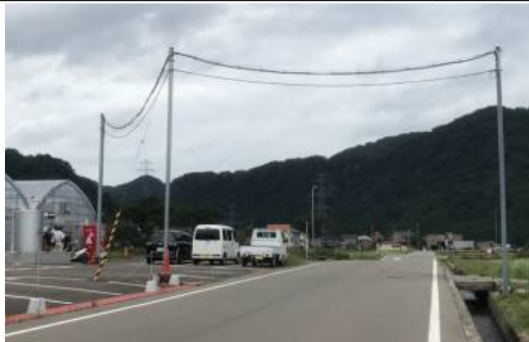
発電所からハウスへの送電線 ©2020 JMA Consultants Inc.
