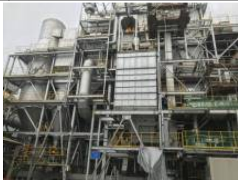
バイオマス発電設備
