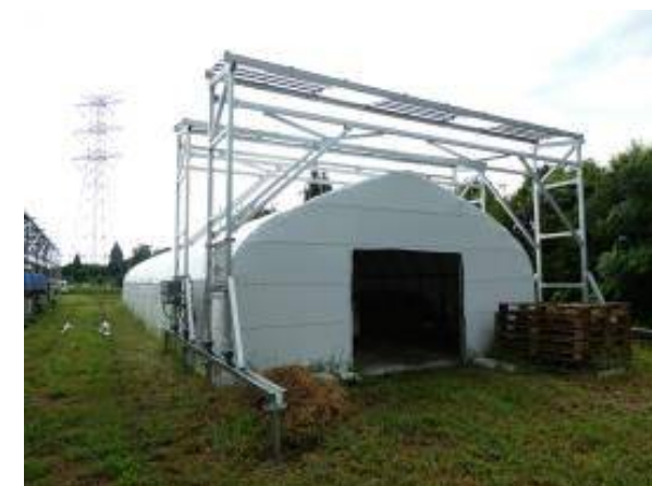
移動可能な太陽光架台
