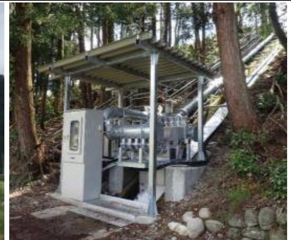
小水力発電設備の外観
