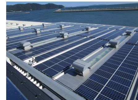
屋根に張り巡らされた太陽光パネル
