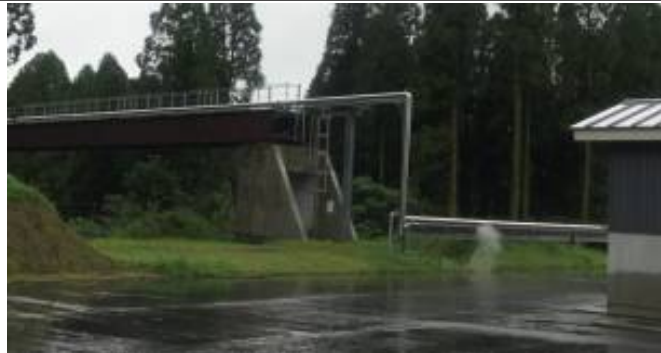
発電設備と工場を繋ぐ蒸気のパイプライン
