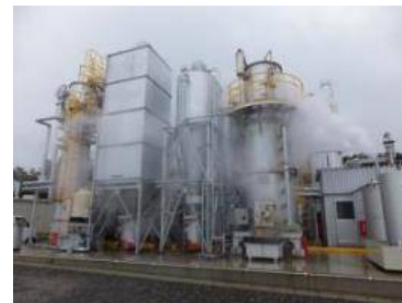
バイオマス設備
